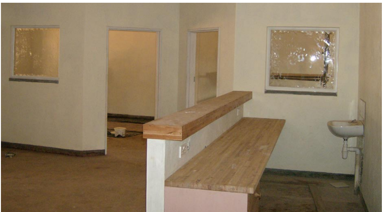
Zweckmässiger und übersichtlicher Mitarbeiterbereich kurz vor Inbetriebnahme
