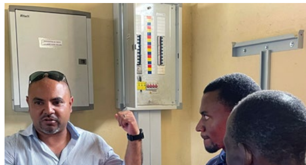
Jay Bashir im Wechselrichterhaus der Solaranlage
